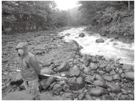
図28. 洗堀されたすりつけ斜路部, 2016年9月9日撮影.
